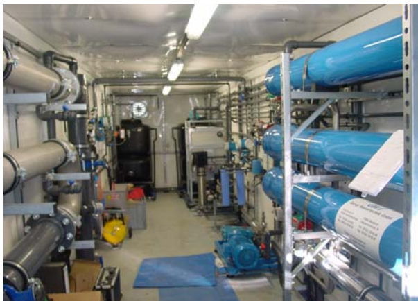
Trepte de ultrafiltrare și osmoză inversă (în container)
