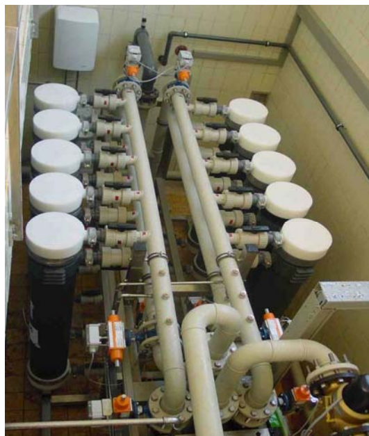
Ultrafiltrare 2 linii paralele
