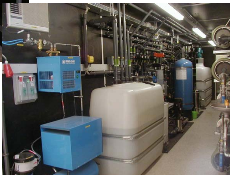
Pretratare pentru osmoză
