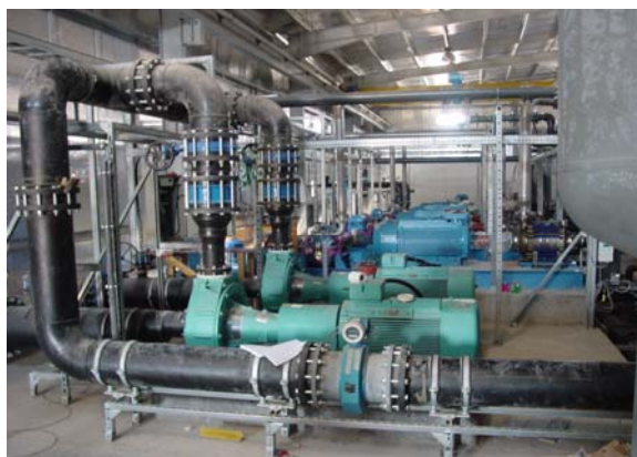
Pompe de alimentare
